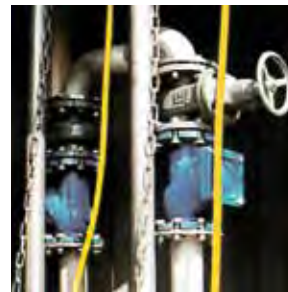
Hochwertige Markenarmaturen und passgenaue, strömungsoptimierte Druckrohrleitung
