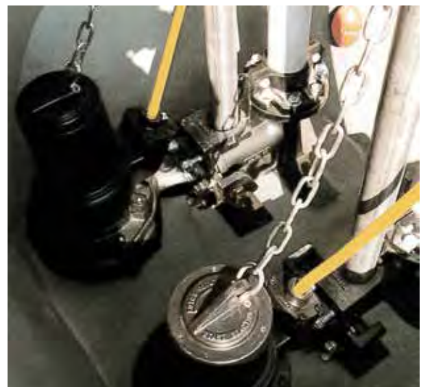
Innenansicht: Betonfertigschacht BFS 1508/2 mit zwei Abwasserpumpen Typ ABS XFP inkl. Kupplungsfußstücke mit Steck-/ Spannvorrichtung und Pumpenführungsrohren
